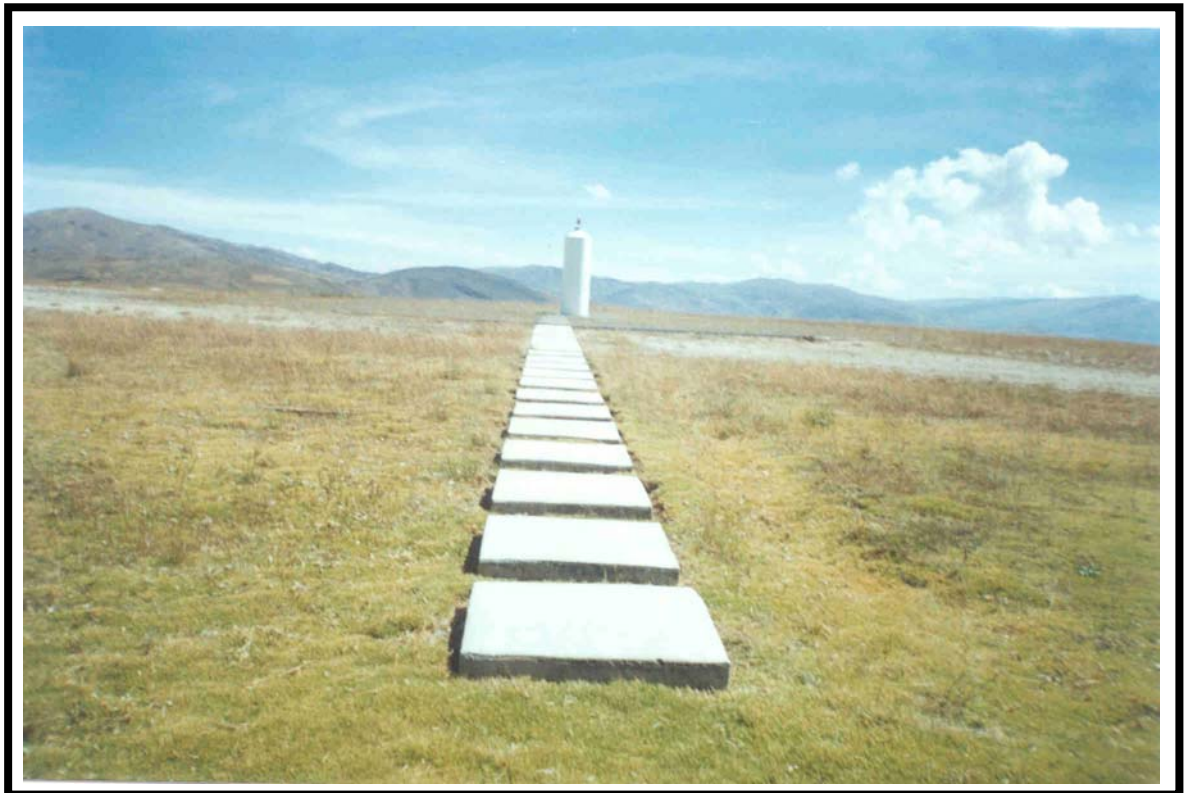
Sistema DME Instalado en el Aeropuerto de Andahuaylas
