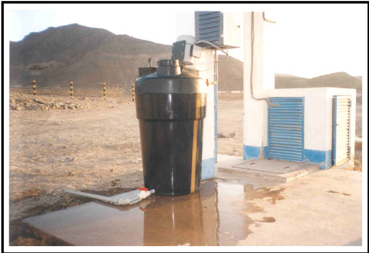
Equipo de Potabilización del agua en el Aeropuerto de Nazca
