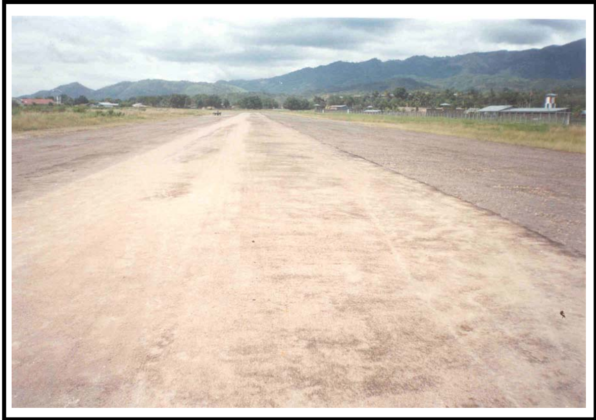
Trabajos de parchado e imprimado en la pista de aterrizaje del Aeropuerto de Juanjui
